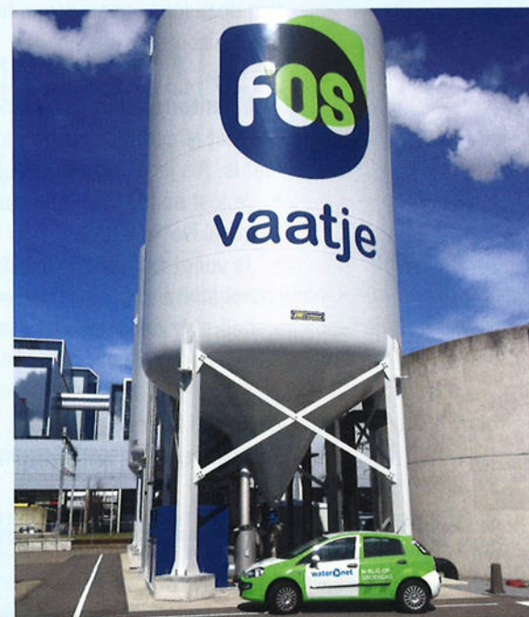
5.15b In 2013 is in Amsterdam de struvietinstallatie FOSvaatje in bedrijf genomen. Deze installatie produceert momenteel ongeveer 900 ton struviet per jaar.
